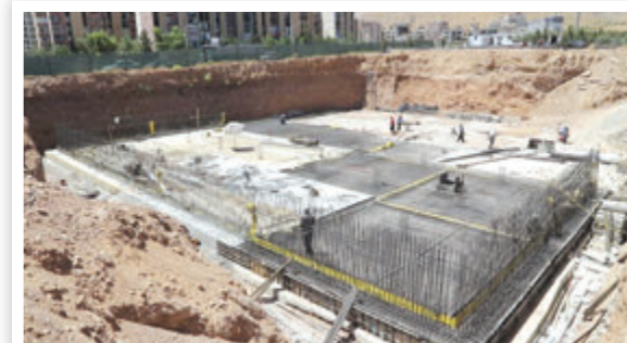
پروژه ۵۰۰۰ متر مکعبی آبیاری فضای سبز پیشرفت فیزیکی: ۲۰ درصد / هدف: آبرسانی به فضای سبز محور شمال غرب
