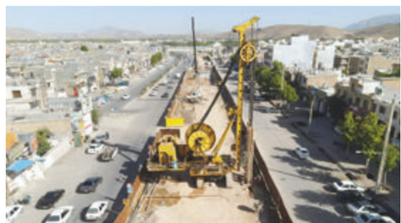
پروژه عمرانی بزرگ مقیاس در حال انجام در شهرداری منطقه ۱۰: پروژه زیرگذر گویم
